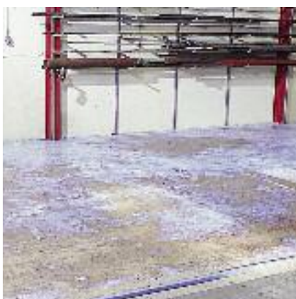
Ytan primas för att få bättre vidhäftning mellan skikten och som skydd mot vattenupptagning.
